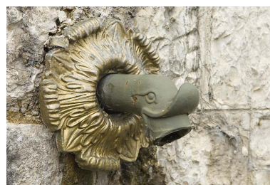
Réservoir des Tavins : sortie en forme de tête de canard. Phot. Jérôme Mongreville IVR43_20082500867NUC2A
