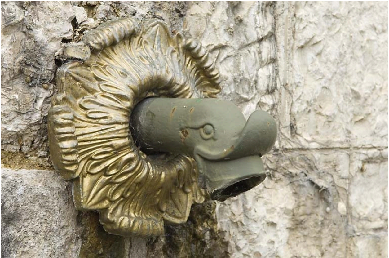
Réservoir des Tavins : sortie en forme de tête de canard.
