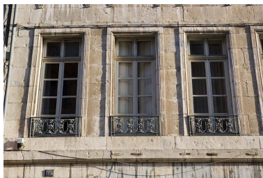
Logis principal sur rue : détail de fenêtres du premier étage. Phot. Yves Sancey IVR43_20082500240NUC2A
