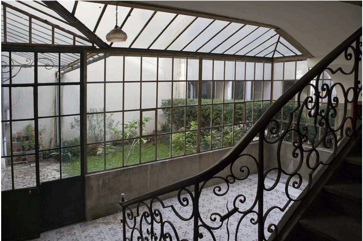
Vue intérieure de la verrière protégeant le rez-de-chaussée de la cage d'escalier.
