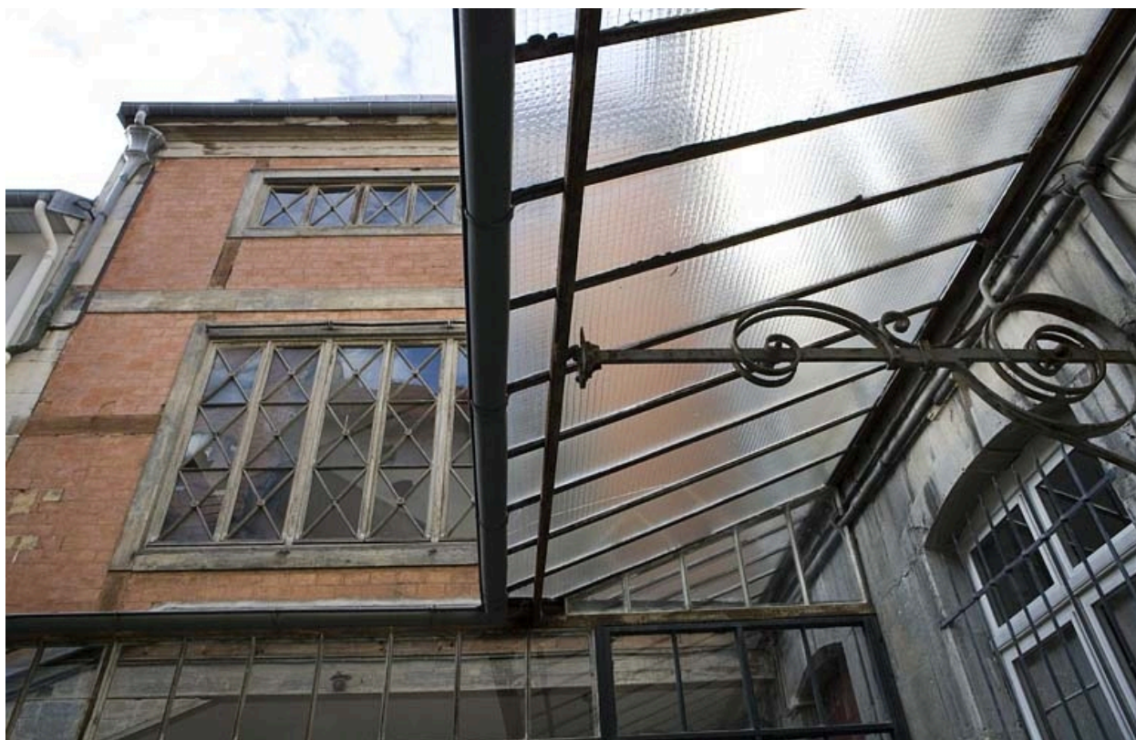
Détail de l'aile contenant l'escalier et de l'auvent situé sur la façade postérieure du logis principal.
