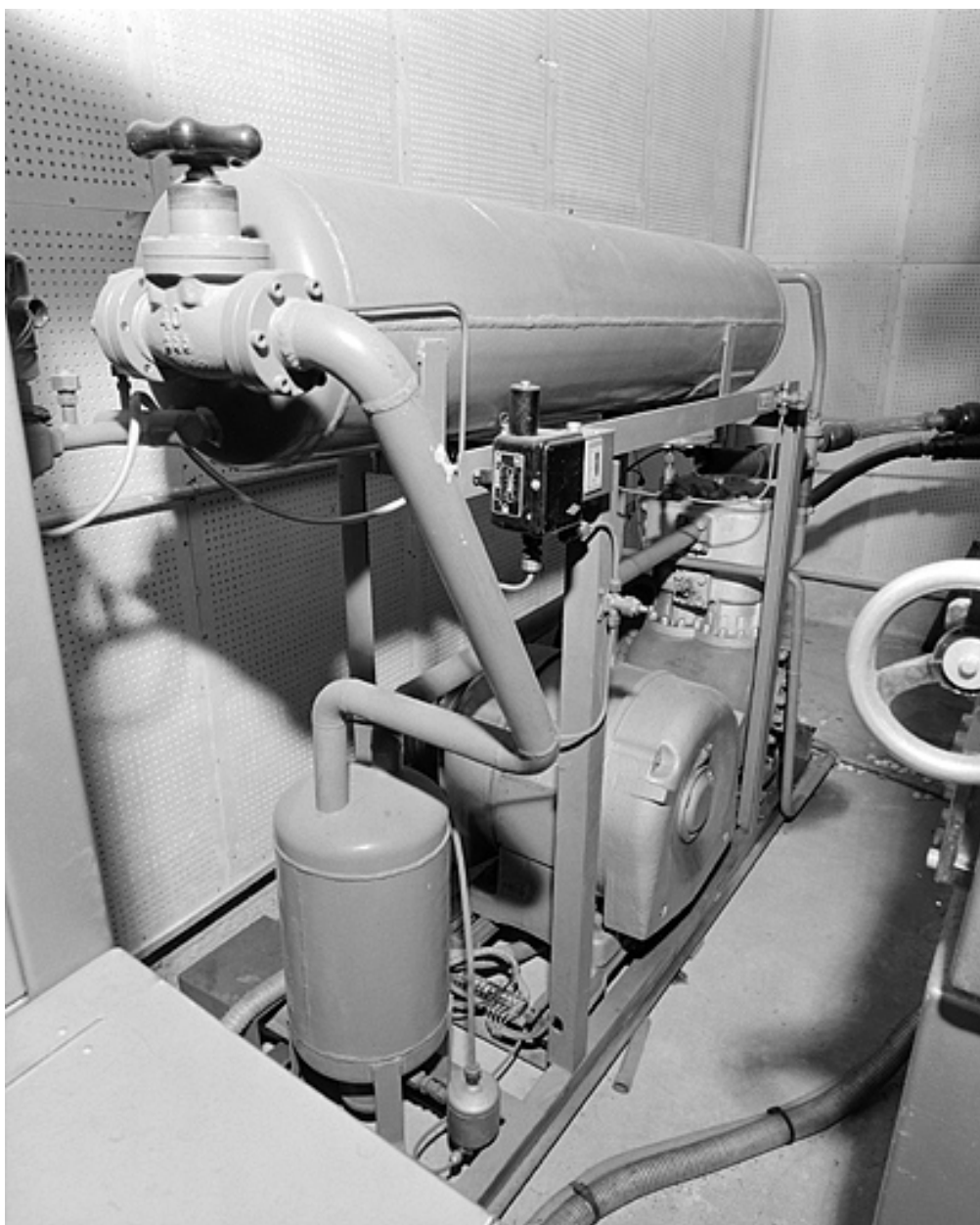
Groupe compresseur - pompe à vide.
