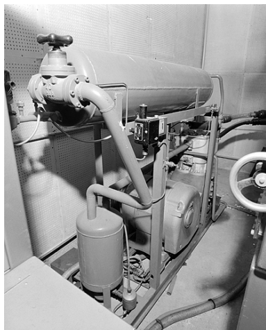
Groupe compresseur - pompe à vide. Phot. Jérôme Mongreville IVR43_20032501015X
