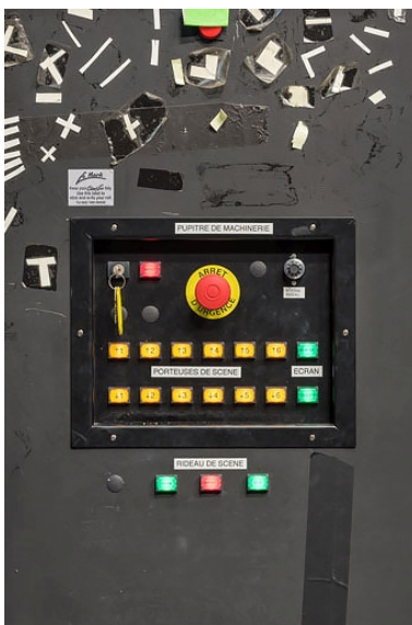
Pupitre de commande de la machinerie. Phot. Pierre-Marie Barbe-Richaud IVR26_20212100385NUC4A
