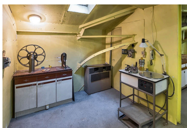
Installation de rembobinage manuel à gauche et table de bobinage Kinoton ST-272 à droite. Phot. Pierre-Marie Barbe-Richaud IVR26_20212100313NUC4A
