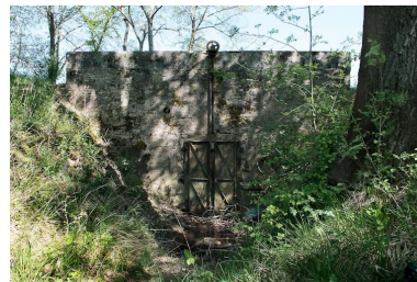
Vanne de l'aqueduc. Phot. Jean-Luc Duthu IVR26_20107100520NUC2A
