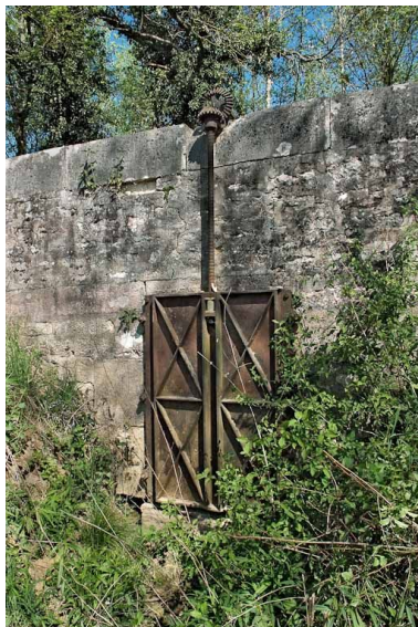
Vanne de l'aqueduc ménagé dans la route-digue. Phot. Jean-Luc Duthu IVR26_20107100521NUC2A
