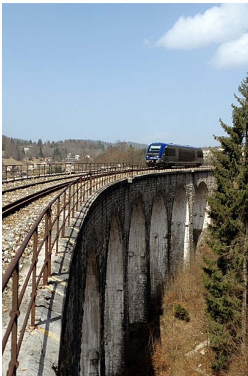
Elévation orientale vue en enfilade depuis le côté La Cluse, avec autorail X 73500.
