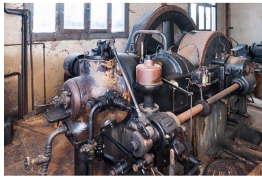
Moteur diesel Duvant. Vue de trois quarts. Phot. Jérôme Mongreville IVR43_20152502399NUC4A
