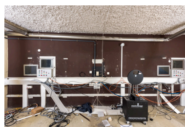
Cinéma : cabine de projection des salles 2 et 3. Phot. Pierre-Marie Barbe-Richaud IVR26_20257100993NUC4A
