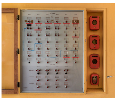
Cinéma : tableau de commande électrique dans le vestibule. Phot. Pierre-Marie Barbe-Richaud IVR26_20257100995NUC2A
