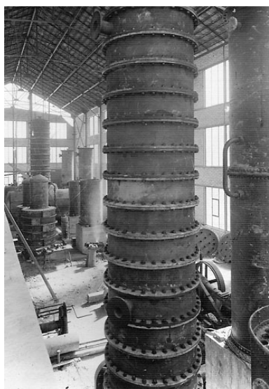
Intérieur de la raffinerie. Colonnes de distillation. Phot. Emile Hérissé, Phot. Emile Hérissé IVR43_20077000477NUCA
