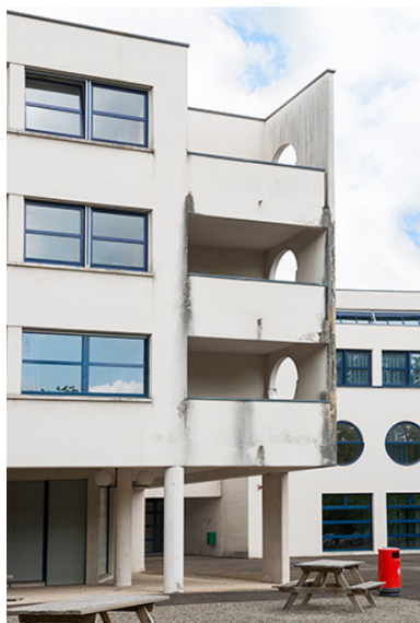
Détail de l'angle est de l'internat sur cour. Phot. Mary Ruffinoni IVR43_20147000013NUC4A
