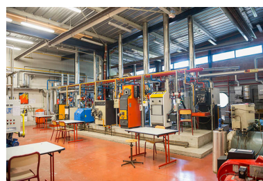
Vue intérieure des ateliers du pôle énergie. Phot. Mary Ruffinoni IVR43_20147000030NUC4A
