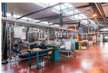
Vue intérieure des ateliers du pôle énergie. Phot. Mary Ruffinoni IVR43_20147000031NUC4A
