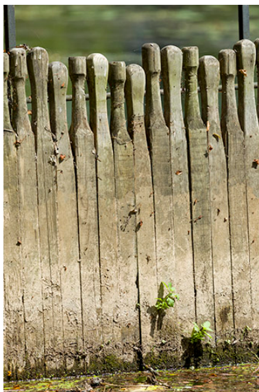
Détail des aiguilles. Phot. Sonia Dourlot IVR43_20167001833NUC2A
