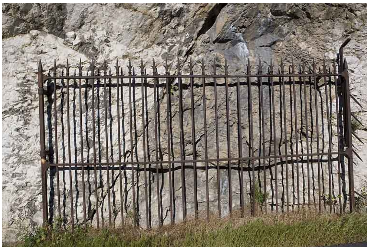
Grille vue de face.
