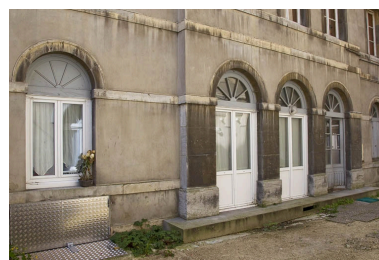
Logis principal, façade antérieure, détail du rez-de- chaussée : de trois quarts gauche.
