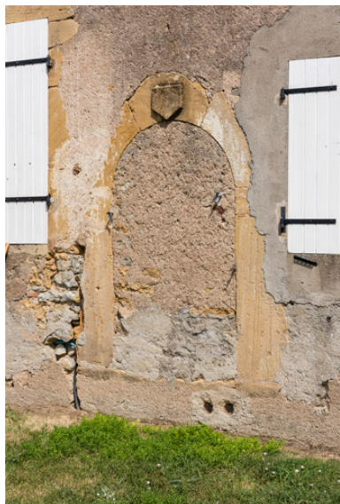
Porte bouchée sur la façade postérieure de la maison, dont la clef est ornée d'une table d'attente (blason nu) Phot. Pierre-Marie Barbe-Richaud IVR26_20197100164NUC4A
