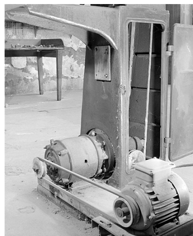
Vue des deux moteurs couplés. Phot. Jérôme Mongreville IVR43_20022500557X
