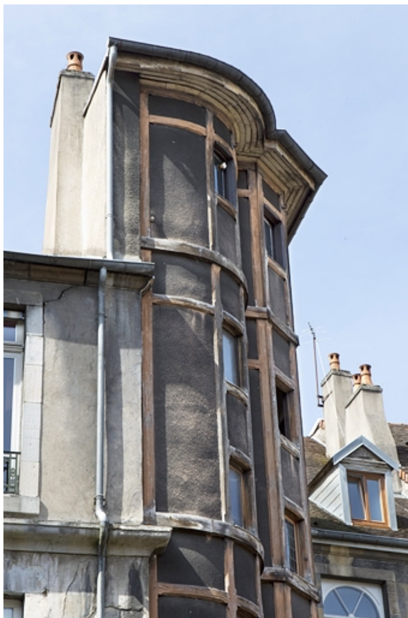
Détail de la partie supérieure de la cage d'escalier en pan de bois.
