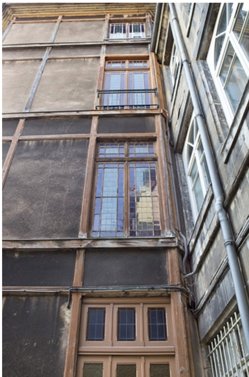
Détail de la paroi de la cage d'escalier en pan de bois.
