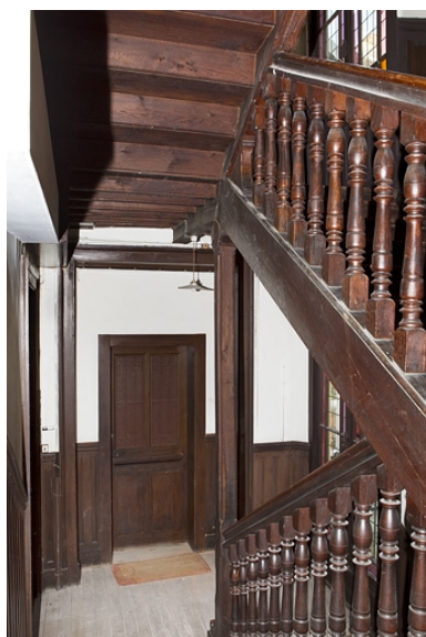
Cage d'escalier en pan de bois : détail de l'escalier. Phot. Yves Sancey
