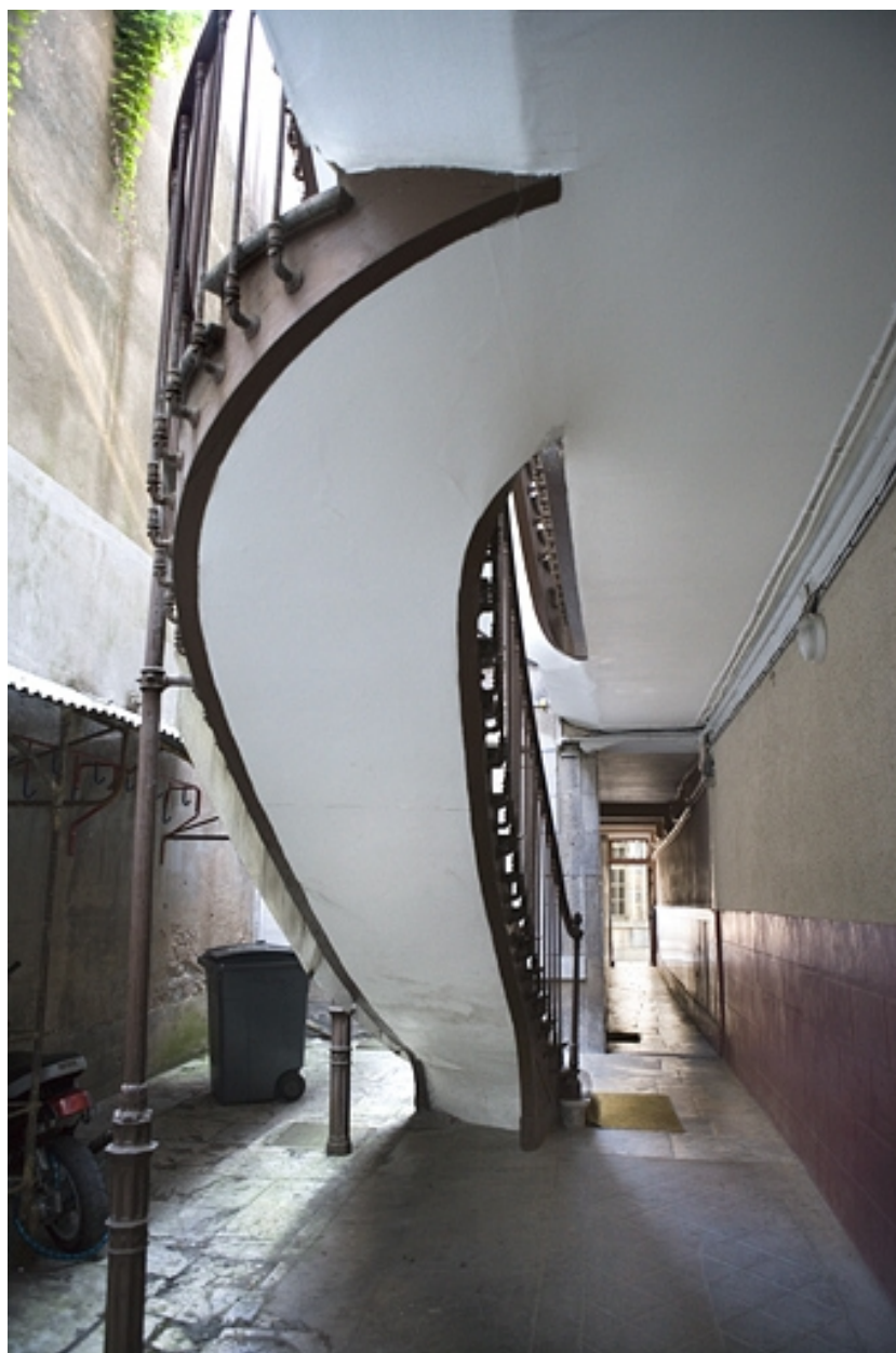
Détail de l'escalier à cage ouverte sur cour, depuis le fond de la première cour.
