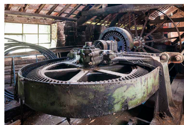
Bâtiment d'eau. Vestiges de la transmission de la centrale hydroélectrique. Phot. Jérôme Mongreville IVR43_20152501626NUC4A
