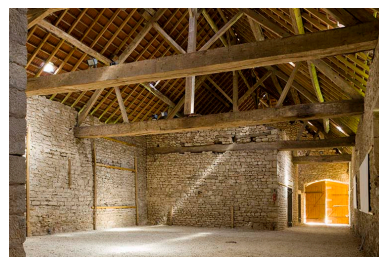
Intérieur du cuvage, en direction du sud-est. Phot. Sonia Dourlot IVR43_20167000746NUC2A
