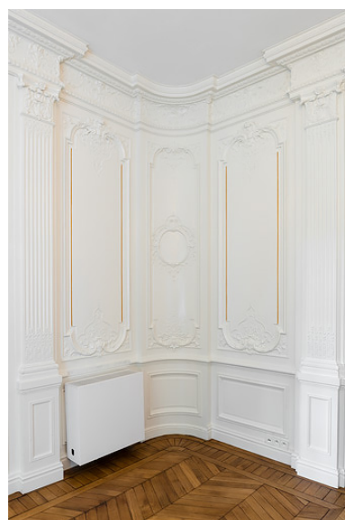
Décor de pilastres dans l'angle sud-ouest de la grande chambre. Phot. Pierre-Marie Barbe-Richaud IVR26_20195800644NUC4A
