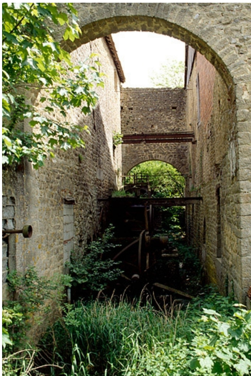
Bâtiment d'eau. Roues hydrauliques en ruine.
