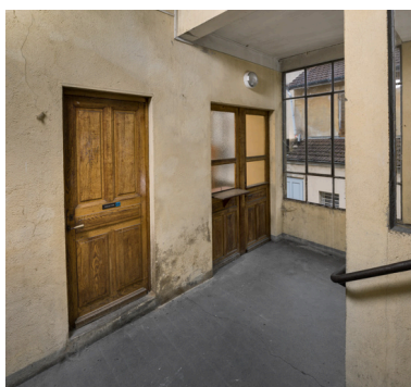
Escalier principal, repos : porte des sanitaires et guichet. Phot. Pierre-Marie Barbe-Richaud IVR26_20257100495NUC4A
