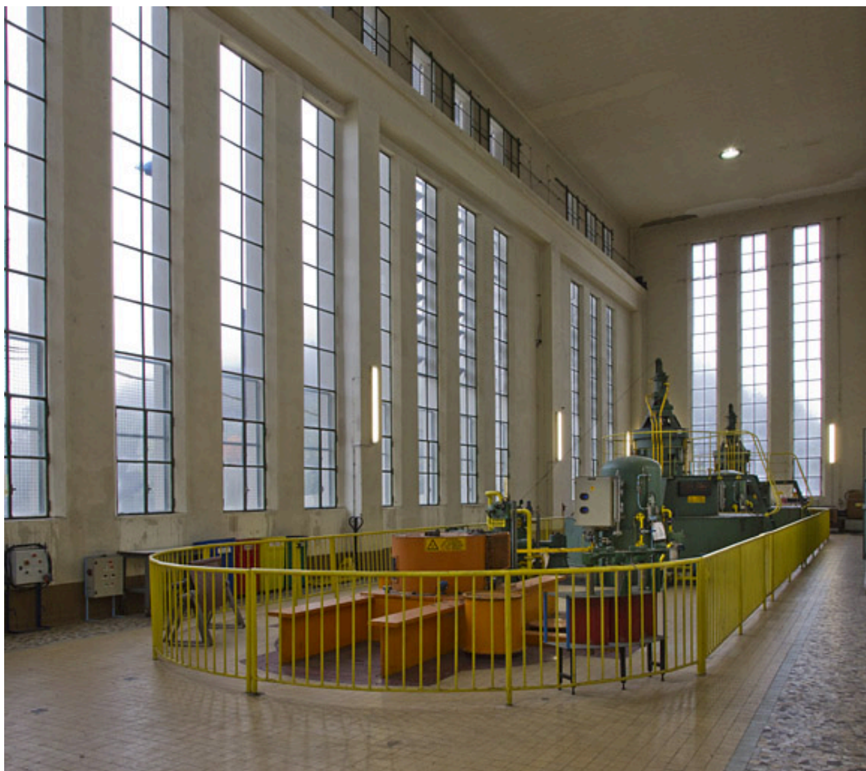
Centrale de Dampjoux : intérieur de la salle des machines.
