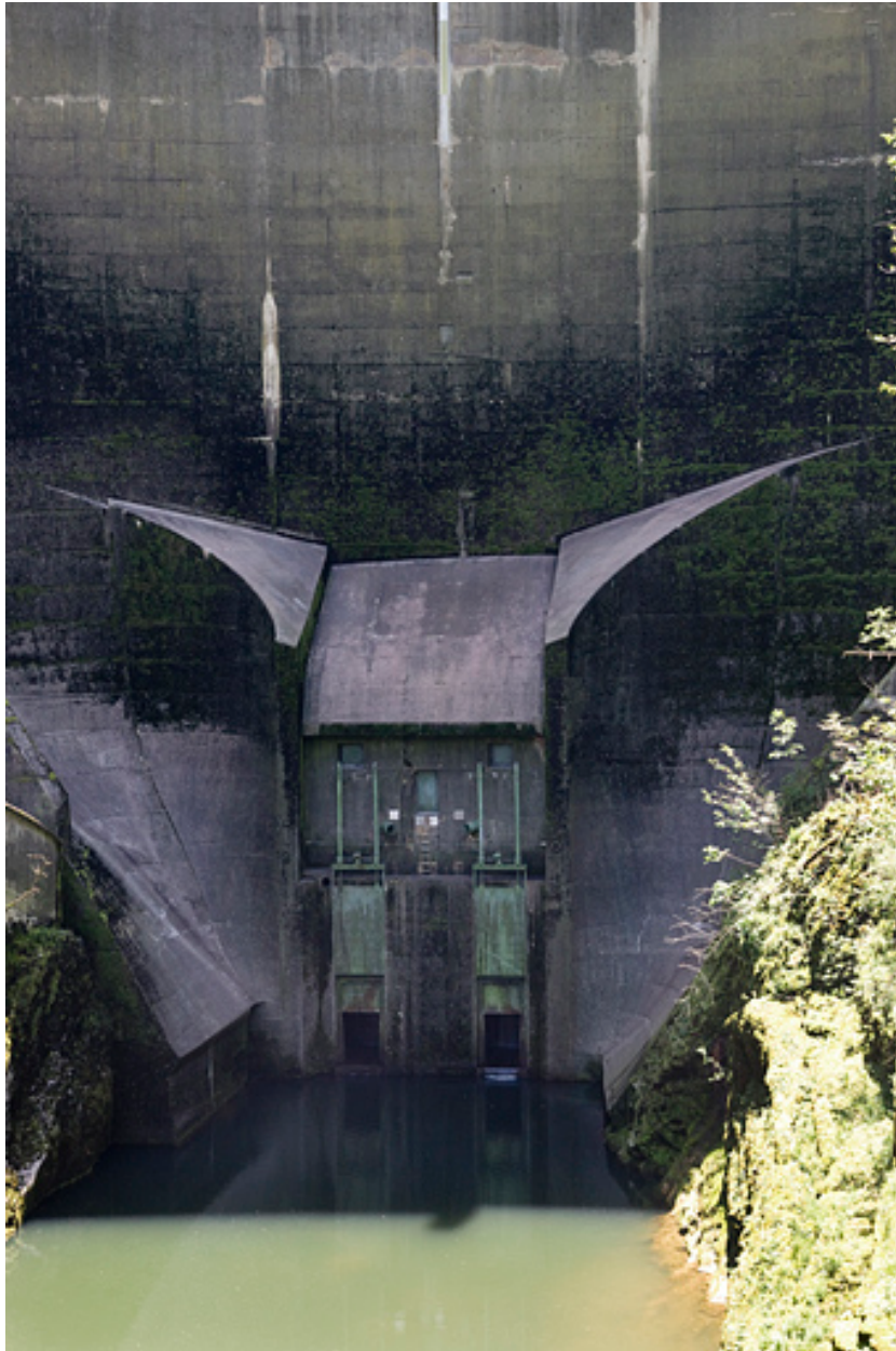
Barrage du Châtelot : vannes de fond.
