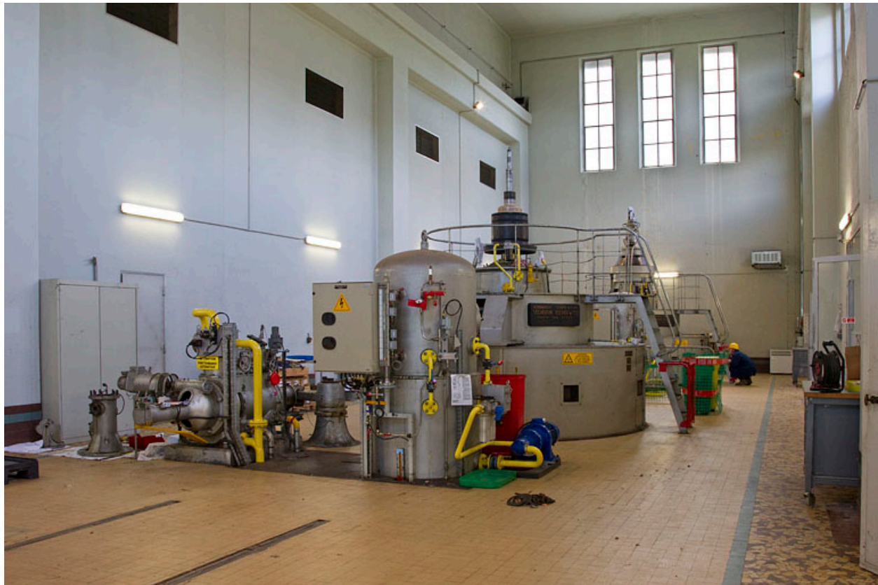
Centrale de Vaufrey : intérieur de la salle des machines.
