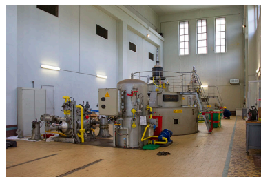
Centrale de Vaufrey : intérieur de la salle des machines. Phot. Yves Sancey IVR43_20122502184NUC2A
