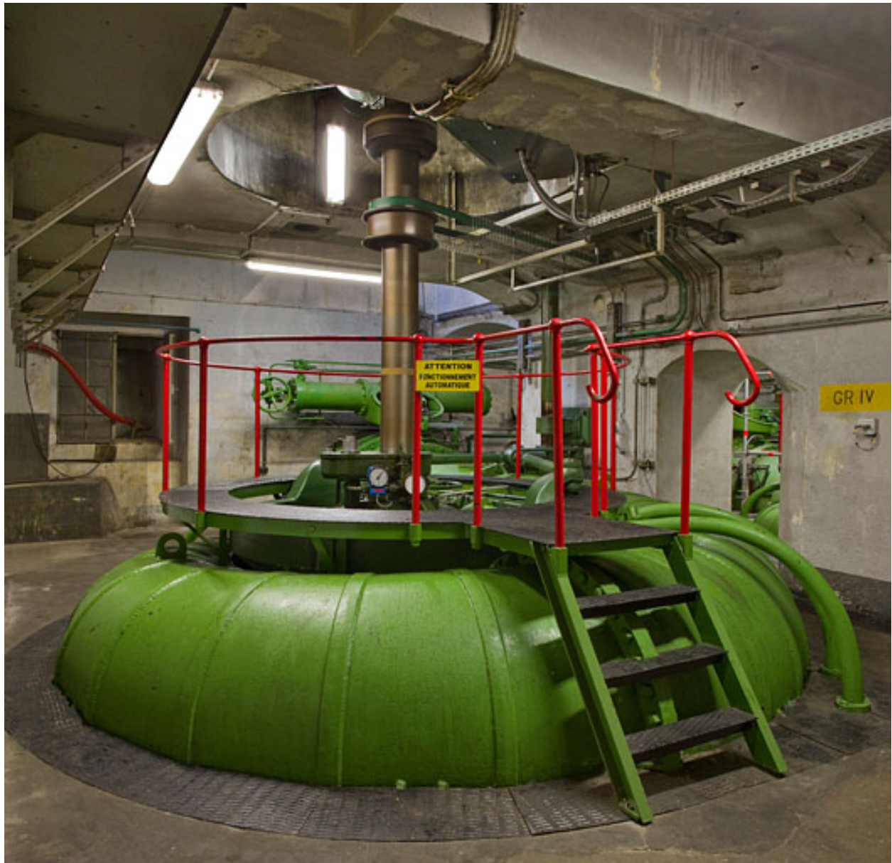
Centrale de Liebvillers : turbine du groupe n° 4.
