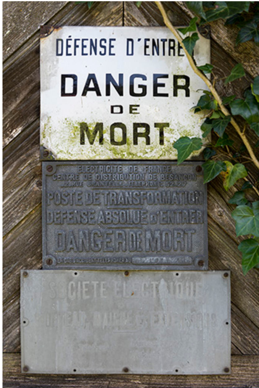
Les Gras : plaques sur le transformateur de la Société électrique de Morteau, Maïche et Extensions.
