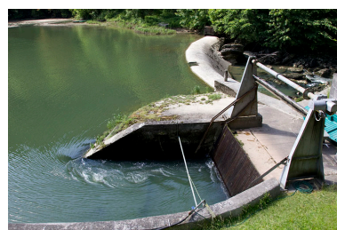
Barrage de la Goule : l'ouvrage de prise d'eau. Phot. Yves Sancey IVR43_20130000004NUC2A
