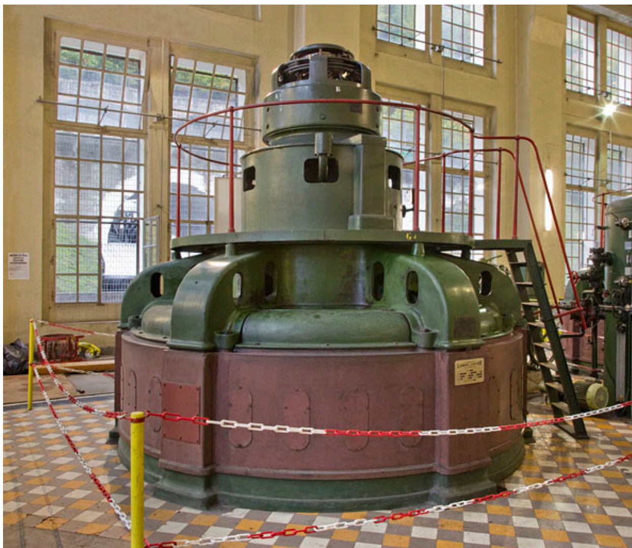
Centrale de Liebvillers : alternateur du groupe n° 4.
