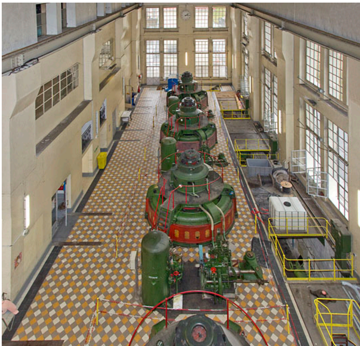
Centrale de Liebvillers : intérieur de la salle des machines.
