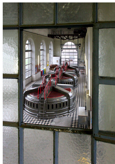
Centrale de la Prétière : intérieur de la salle des machines.
