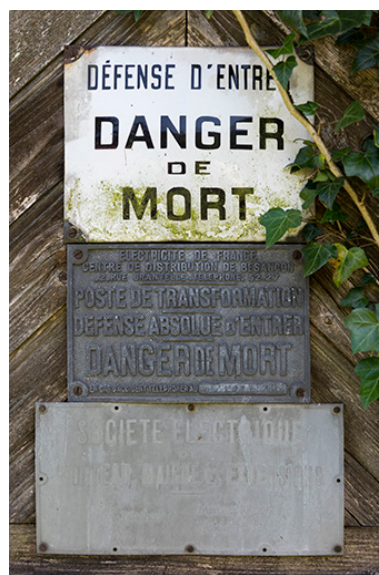
Les Gras : plaques sur le transformateur de la Société électrique de Morteau, Maîche et Extensions.
