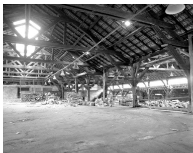
Ateliers de fabrication (J) : intérieur de l'atelier de soudure (J4). Rampe d'accès au fond, atelier des presses dans le vaisseau (J3) à droite. Phot. Yves Sancey IVR43_19943901679X
