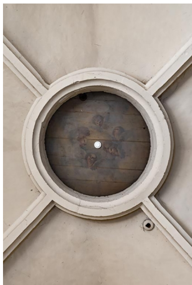
Tour sud, rez-de-chaussée (loge d'acteur côté cour) : ouverture zénithale, avec couvercle peint. Phot. Pierre-Marie Barbe-Richaud IVR26_20222100468NUC4A
