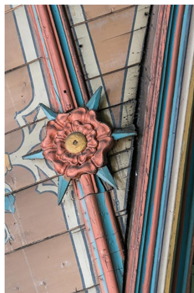
Nef, charpente lambrissée : peinture et motif floral sculpté. Phot. Pierre-Marie Barbe-Richaud IVR26_20222100433NUC4A
