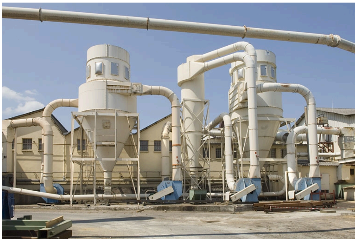
Installation de traitement de la sciure.
