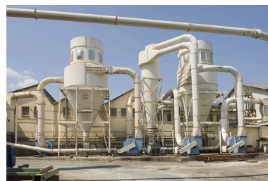
Installation de traitement de la sciure. Phot. Jérôme Mongreville
