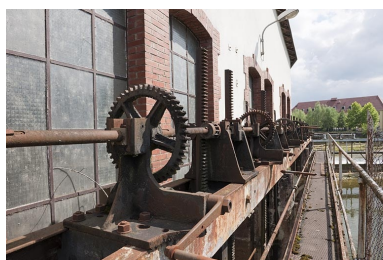
Détail du vannage de prise d'eau.
