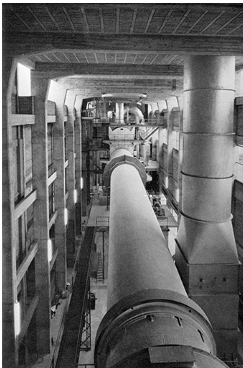
Vue d'ensemble du four rotatif.
