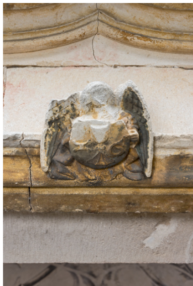
Linteau, détail : ange portant l'écu de Jehan Géliot. Phot. Pierre-Marie Barbe-Richaud IVR26_20237100236NUC4A
