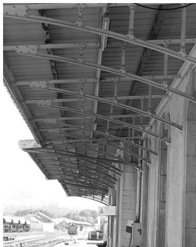
Bâtiment des voyageurs : vue d'ensemble des consoles métalliques soutenant l'auvent. Phot. Yves Sancey IVR43_20043900169X
