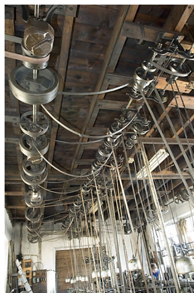
Système de transmission. Phot. Jérôme Mongreville IVR43_20082500028NUC2A
