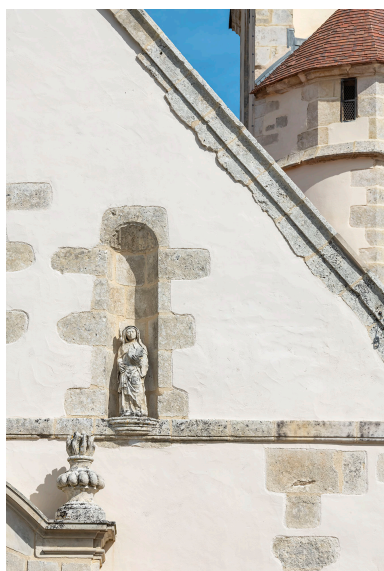
Détail de la façade principale : niche et pot à feu. Phot. Thierry Kuntz IVR26_20248900228NUC4A
