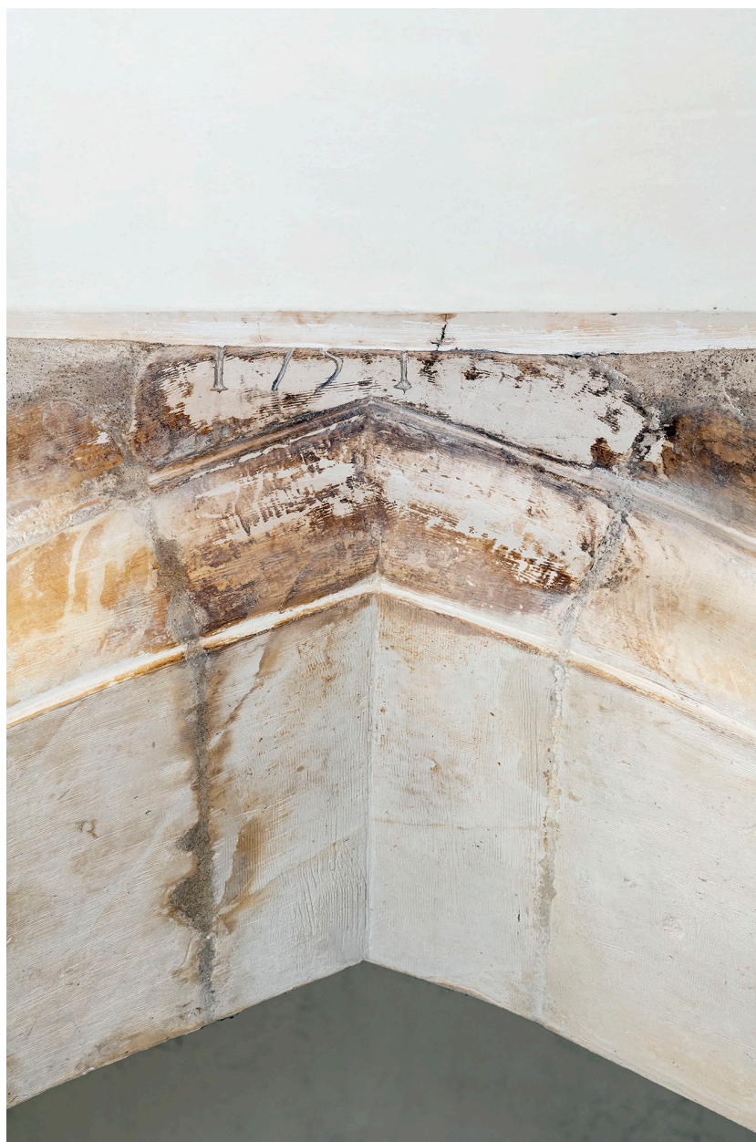
Arc brisé du transept nord : date (1751).
