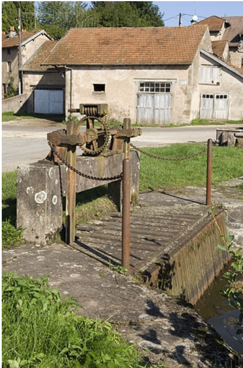
Vanne de prise d'eau de l'étang.
