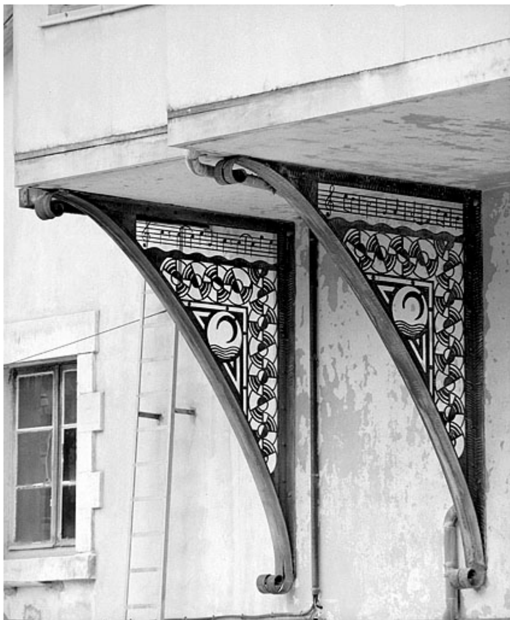
Consoles de la cabine de projectionniste.
