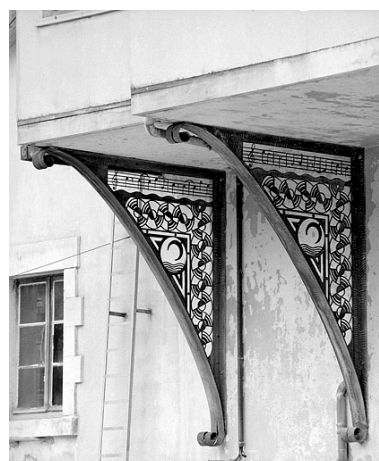
Consoles de la cabine de projectionniste. Phot. Jérôme Mongreville IVR43_19923900565X
