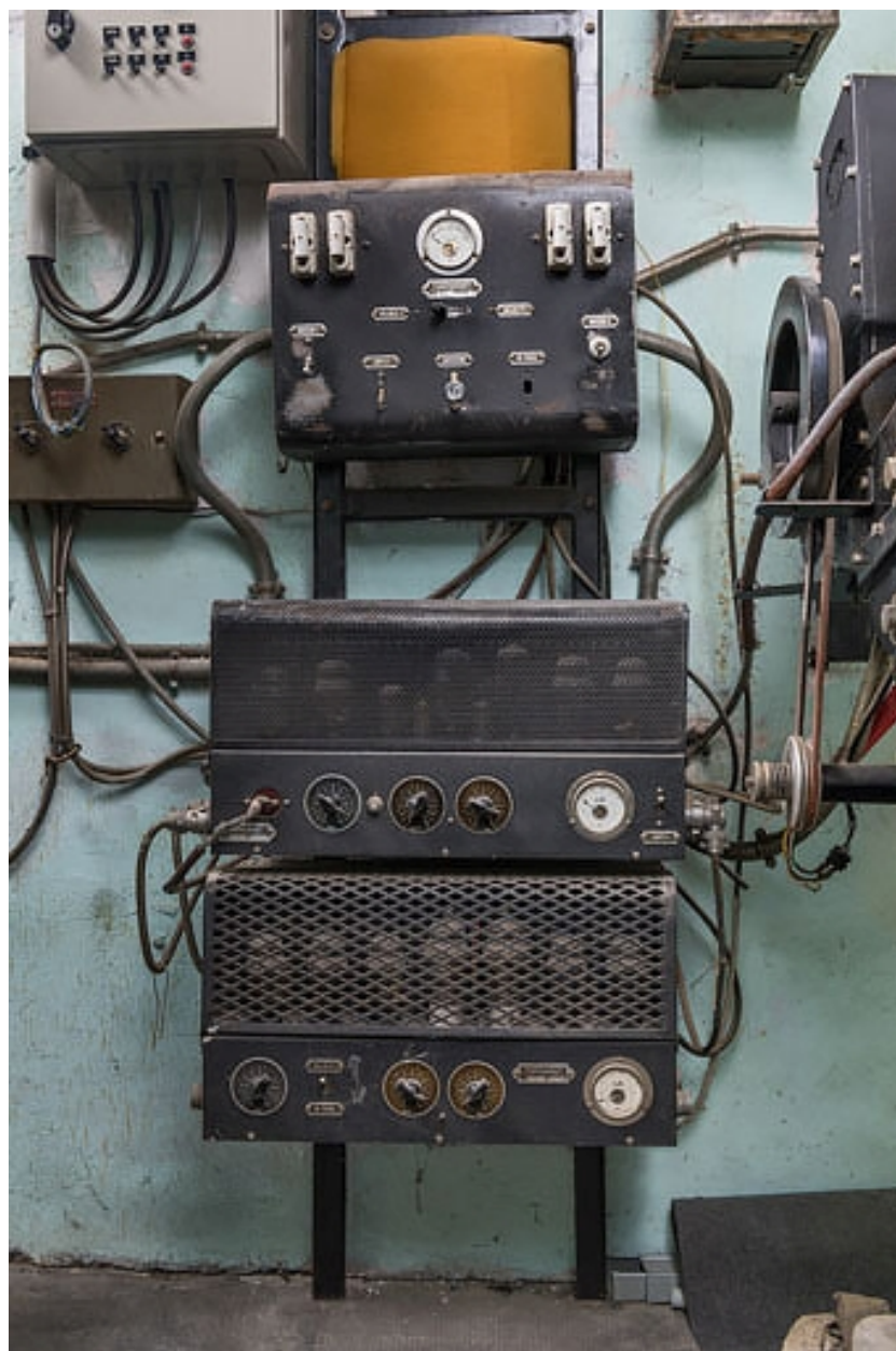
Installation de sonorisation : amplificateurs.
