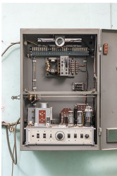
Armoire de commande Philips, porte ouverte. Phot. Pierre-Marie Barbe-Richaud IVR26_20222100060NUC4A
