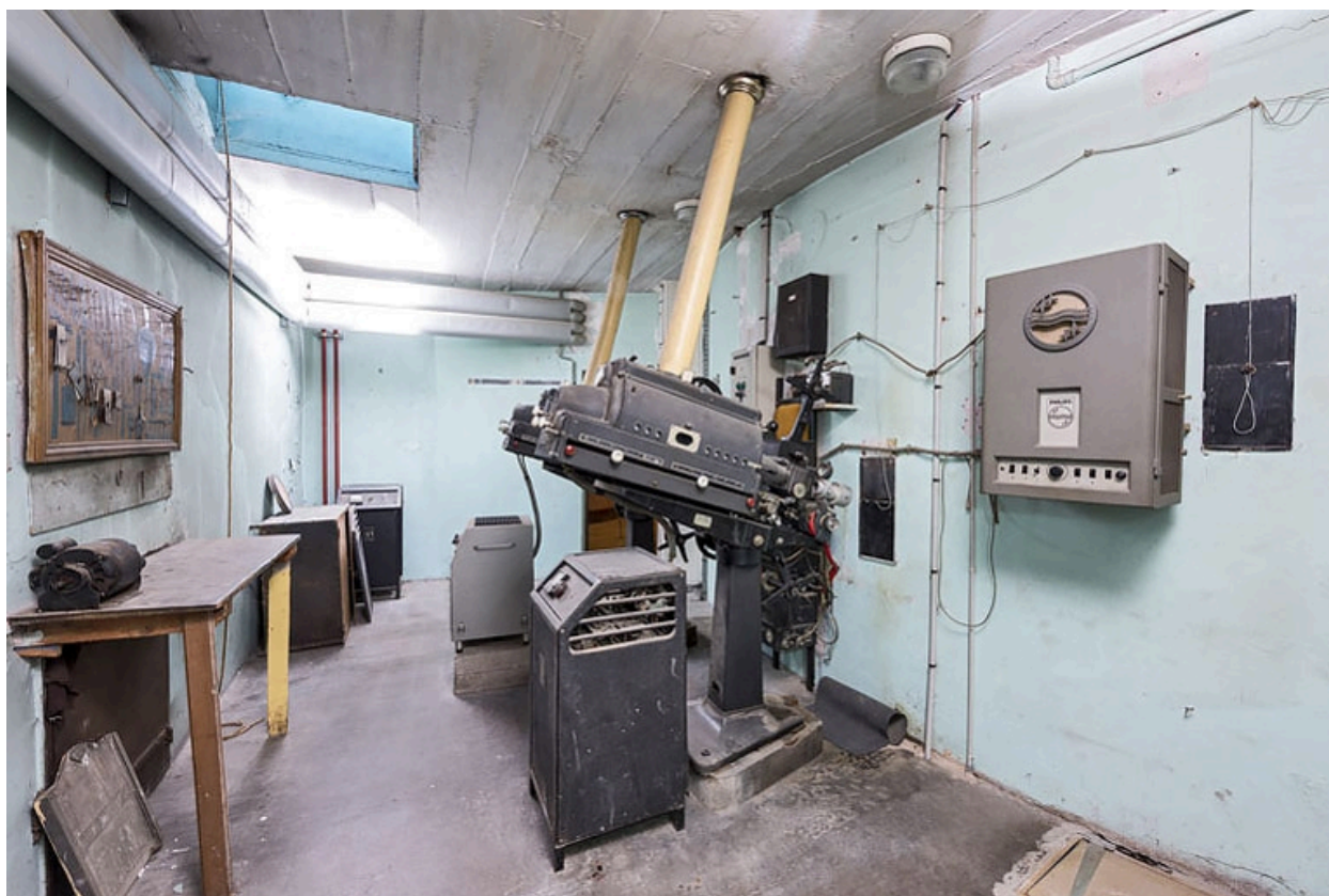
Vue d'ensemble de la cabine, depuis la porte côté cour.
