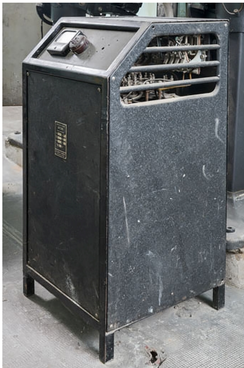
Redresseur Rectarc désaffecté.
