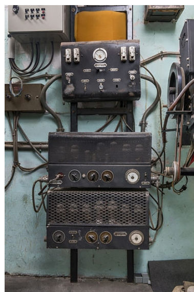
Installation de sonorisation : amplificateurs. Phot. Pierre-Marie Barbe-Richaud IVR26_20222100058NUC4A
