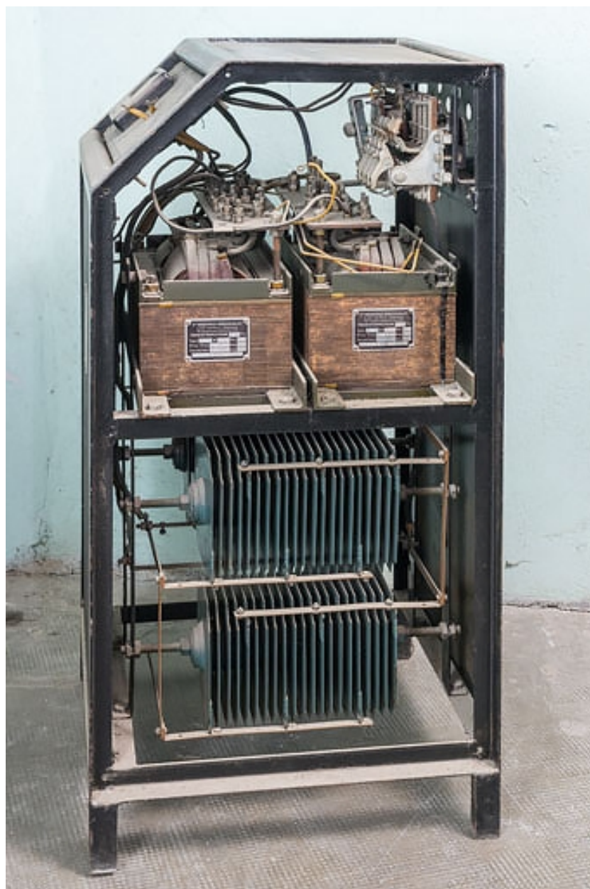
Redresseur Rectarc désaffecté : vue de profil, tôle de protection enlevée.
