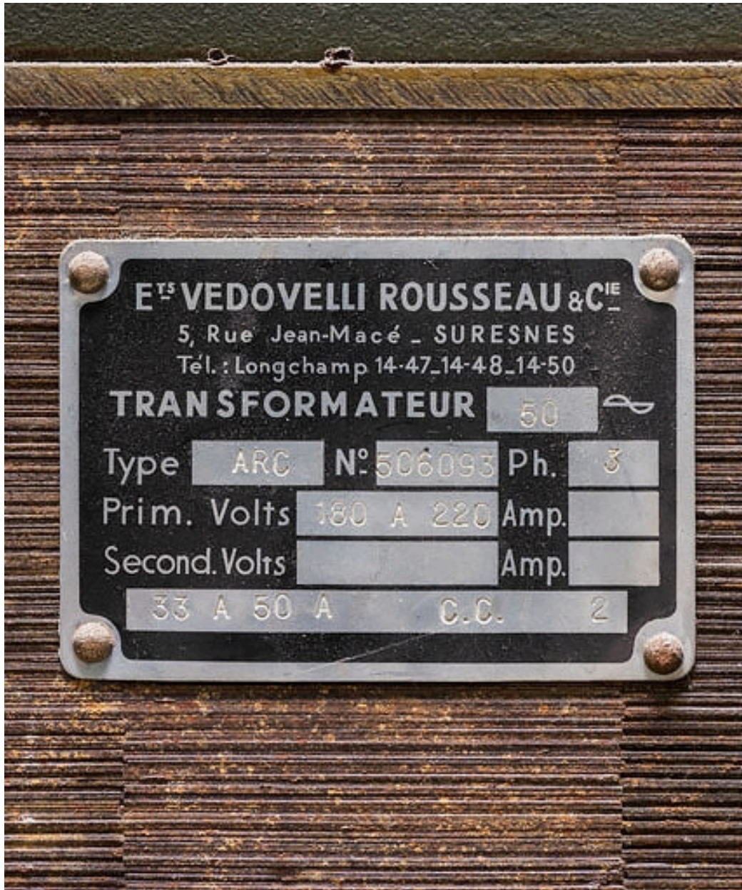
Redresseur Rectarc désaffecté : plaque de constructeur sur l'un des éléments.
