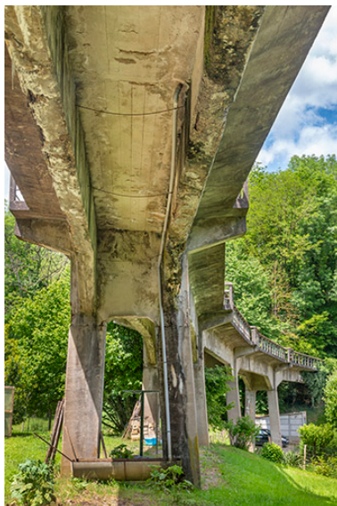
Vue prise sous le pont, depuis la route de Chaux-Champagny. Phot. Jérôme Mongreville IVR43_20243900785NUC4A
