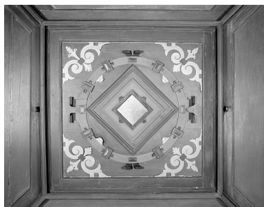
Tour Henriette. Pièce du quatrième niveau. Détail du plafond. Phot. Jérôme Mongreville IVR43_19872500946X
