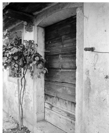
Détail de la porte d'entrée sur la façade antérieure. Phot. Yves Sancey IVR43_19772500354X
