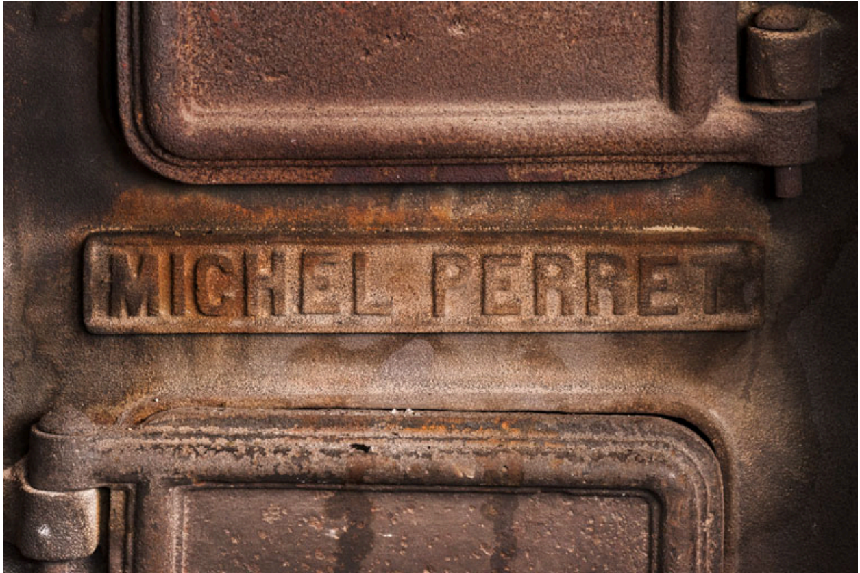
Calorifère au sous-sol, détail : plaque de firme ("Michel Perret").
