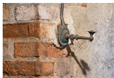
Luminaire d'applique au sous-sol.
