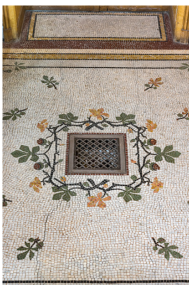
Vestibule du rez-de-chaussée, grille de chauffage au sol. Phot. Pierre-Marie Barbe-Richaud IVR26_20245800210NUC4A
