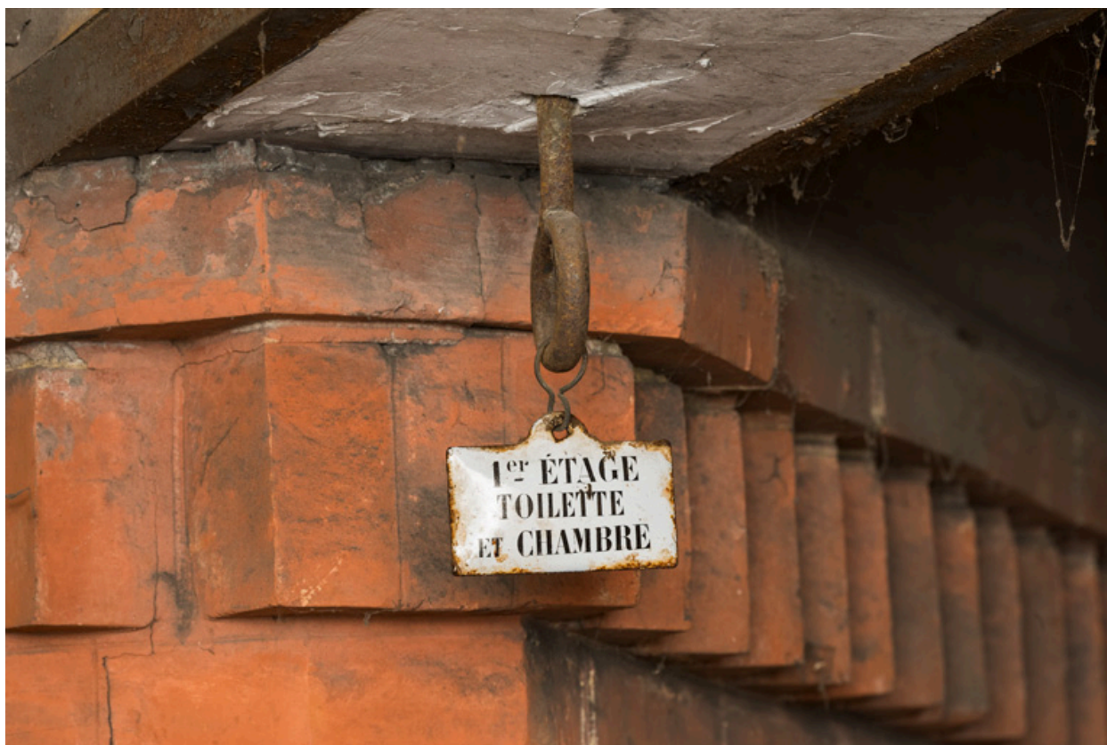
Calorifère au sous-sol, détail : étiquette suspendue à un conduit ("1er étage toilette et chambre").
