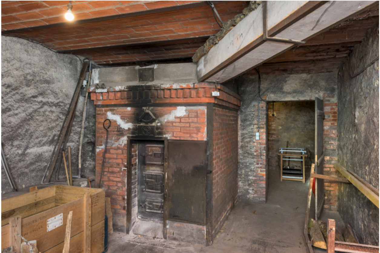
Calorifère au sous-sol.
