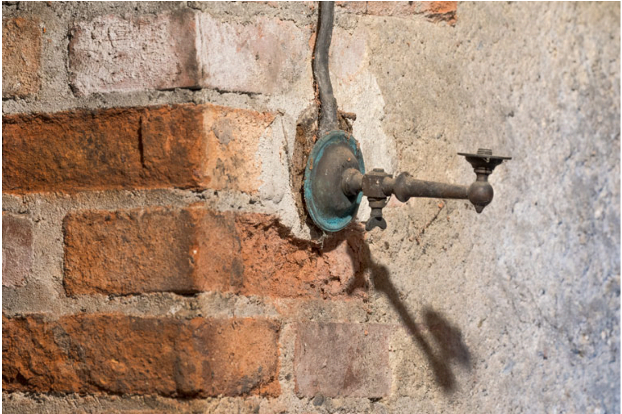
Luminaire d'applique au sous-sol.
