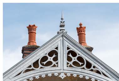
Lambrequin métallique découpé imitant un décor de menuiserie et cheminées ornées. Phot. Pierre-Marie Barbe-Richaud IVR26_20195800693NUC4A
