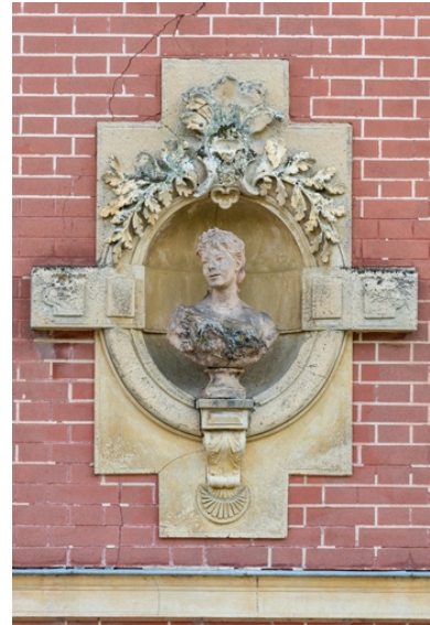
4e buste (à droite sur l'élévation de la maison). Phot. Pierre-Marie Barbe-Richaud IVR26_20222100867NUC4A
