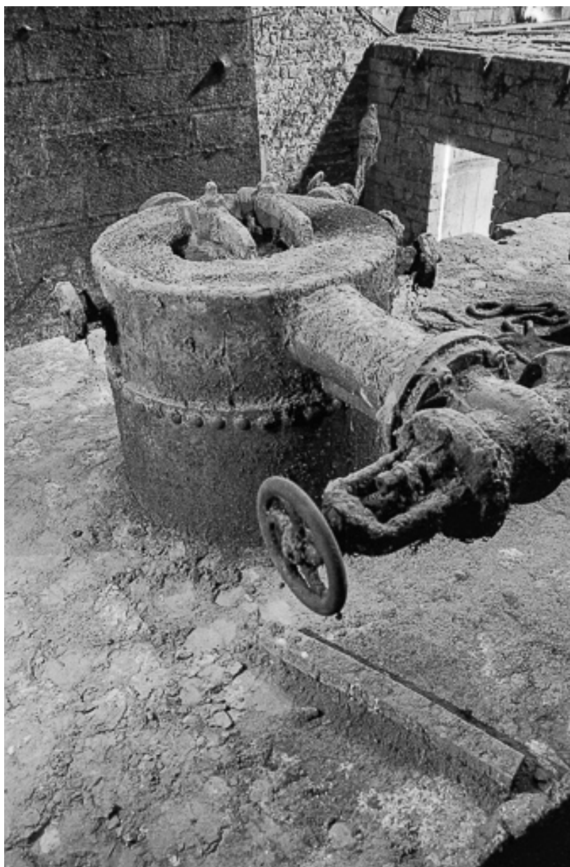
Partie supérieure de la chaudière. Vannage.
