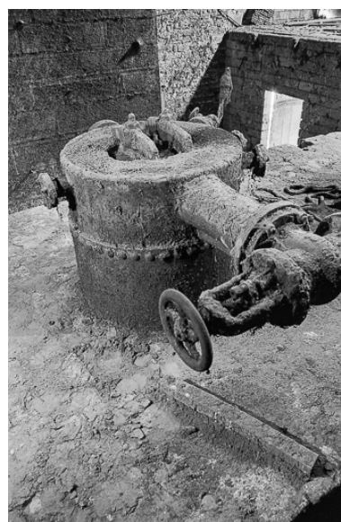
Partie supérieure de la chaudière. Vannage.
