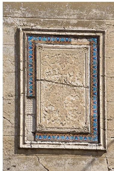
Détail de décor polychrome en céramique sur la façade. Phot. Jérôme Mongreville IVR43_20217000336NUC4A
