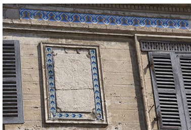
Détail de décor polychrome en céramique sur la façade. Phot. Jérôme Mongreville IVR43_20217000338NUC4A
