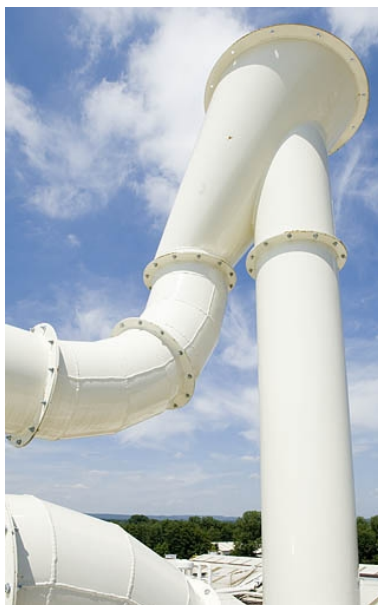
Tuyauterie d'un silo.
