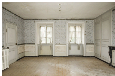
Chambre avec alcôve, vue en direction des fenêtres ouvrant sur la rue du Château. Phot. Jérôme Mongreville IVR43_20082500822NUC2A
