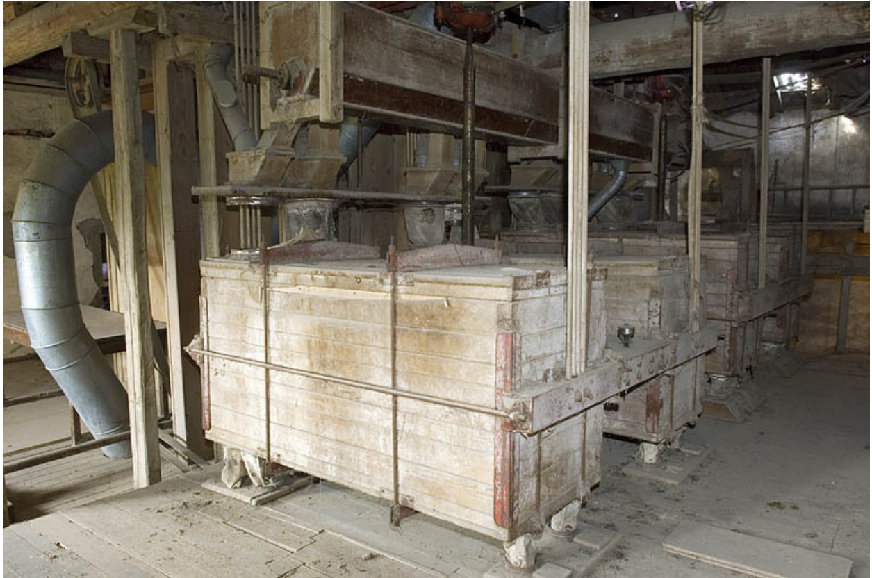
Vue d'ensemble des plansichters (3e étage).
