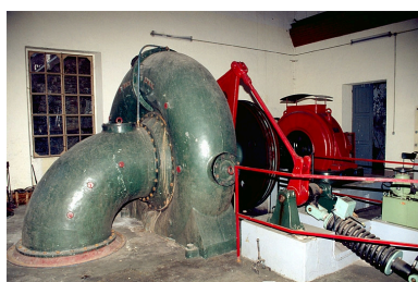
Vue rapprochée de la turbine n° 3. Phot. Jérôme Mongreville IVR43_19973900530ZA
