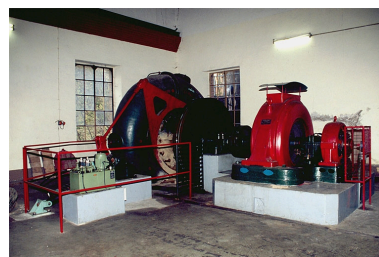
Groupe turbine alternateur n° 3. Phot. Jérôme Mongreville IVR43_19973900529ZA
