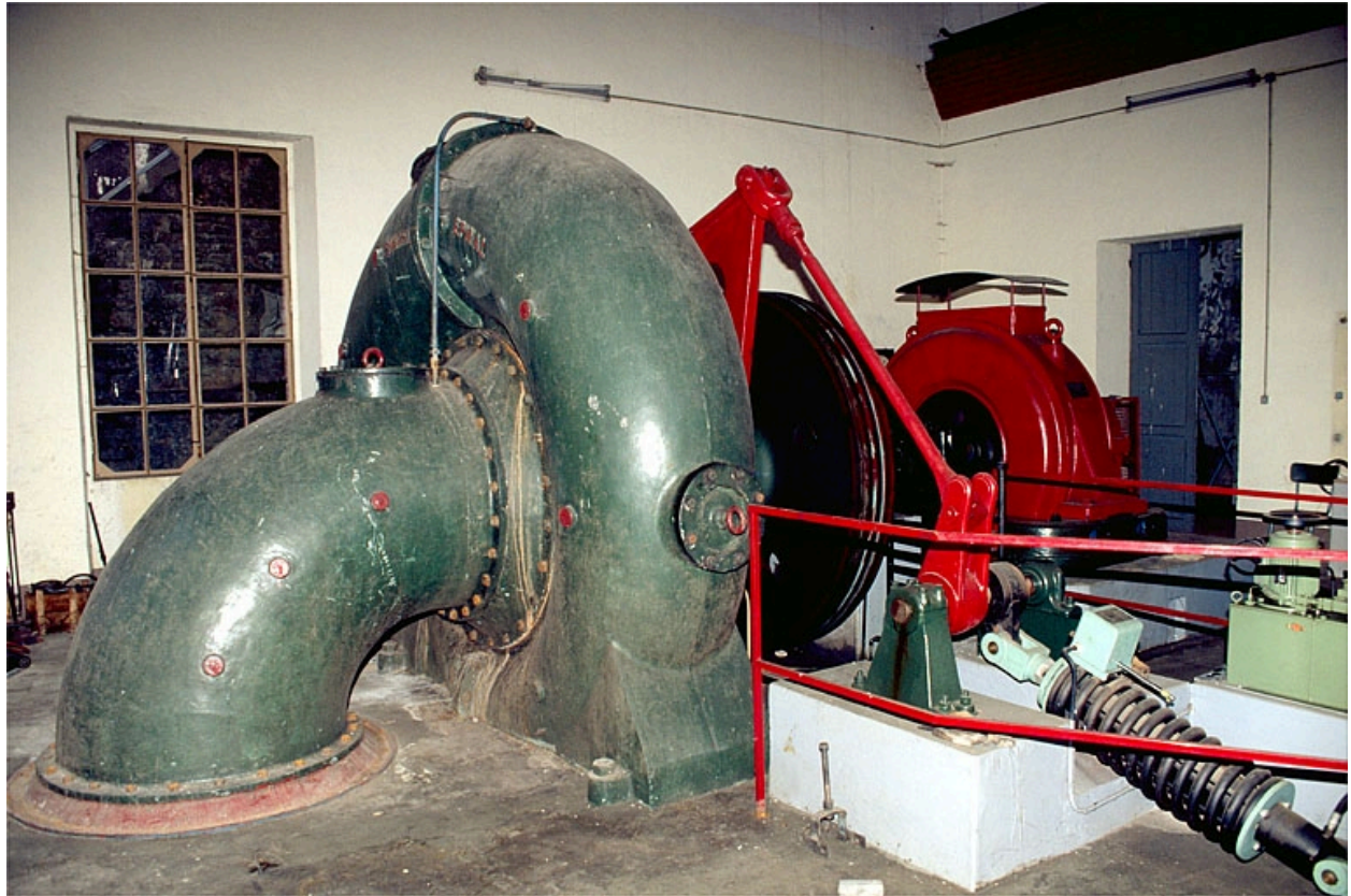
Vue rapprochée de la turbine n° 3.
