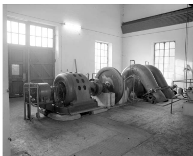
Groupe turbine alternateur n° 1. Phot. Jérôme Mongreville IVR43_19973900531X
