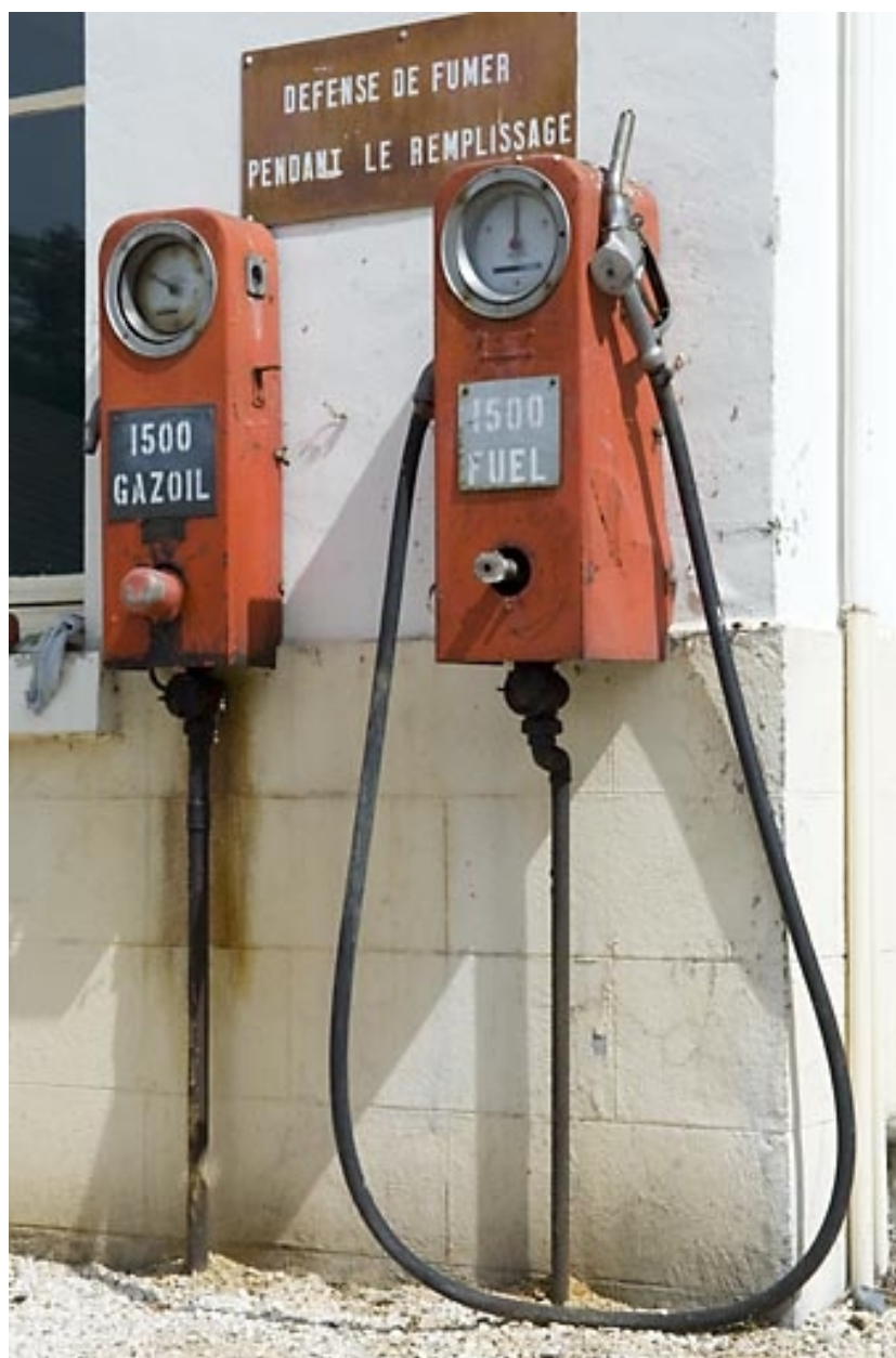
Poste de distribution d'essence.
